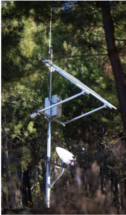
Control perimetral y comunicación vía satélite
